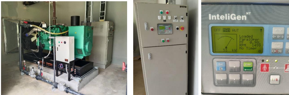
รูปการใช้ประโยชน์จากก๊าซชีวมวลในการผลิตกระแสไฟฟ้าสำหรับเครื่องกำลังผลิต 80 kWp
