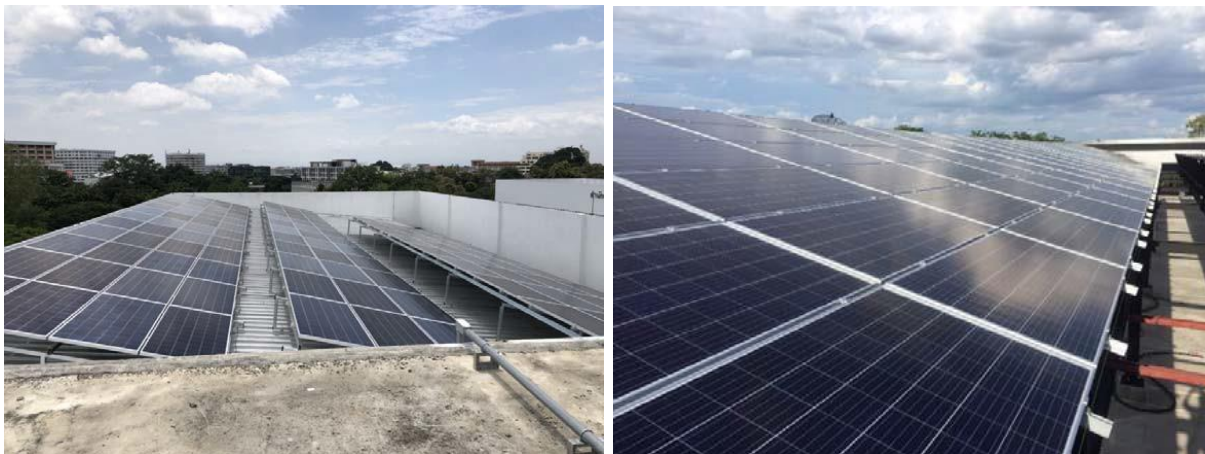
รูปการติดตั้งโซลาร์หลังคาสำนักงาน 2 และอาคารจอดรถ S1 พิกัดติดตั้งรวม 121.6 kWp
